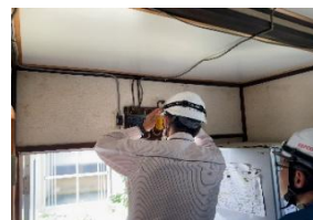
漏電遮断器の設置
